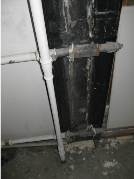
Figur 2-2 Eksempel på gamle PCB-holdige fuger ved nedtaget skillevæg 174
