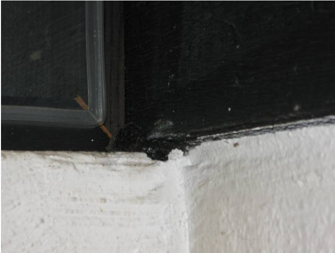
Figur 2-7 Eksempel på PCB-holdig fugebånd anvendt ved forsatsvindue mellem skillevæg, bjælke og facade fra 1972. 187
